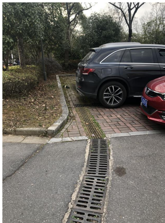
停车场雨水管网
